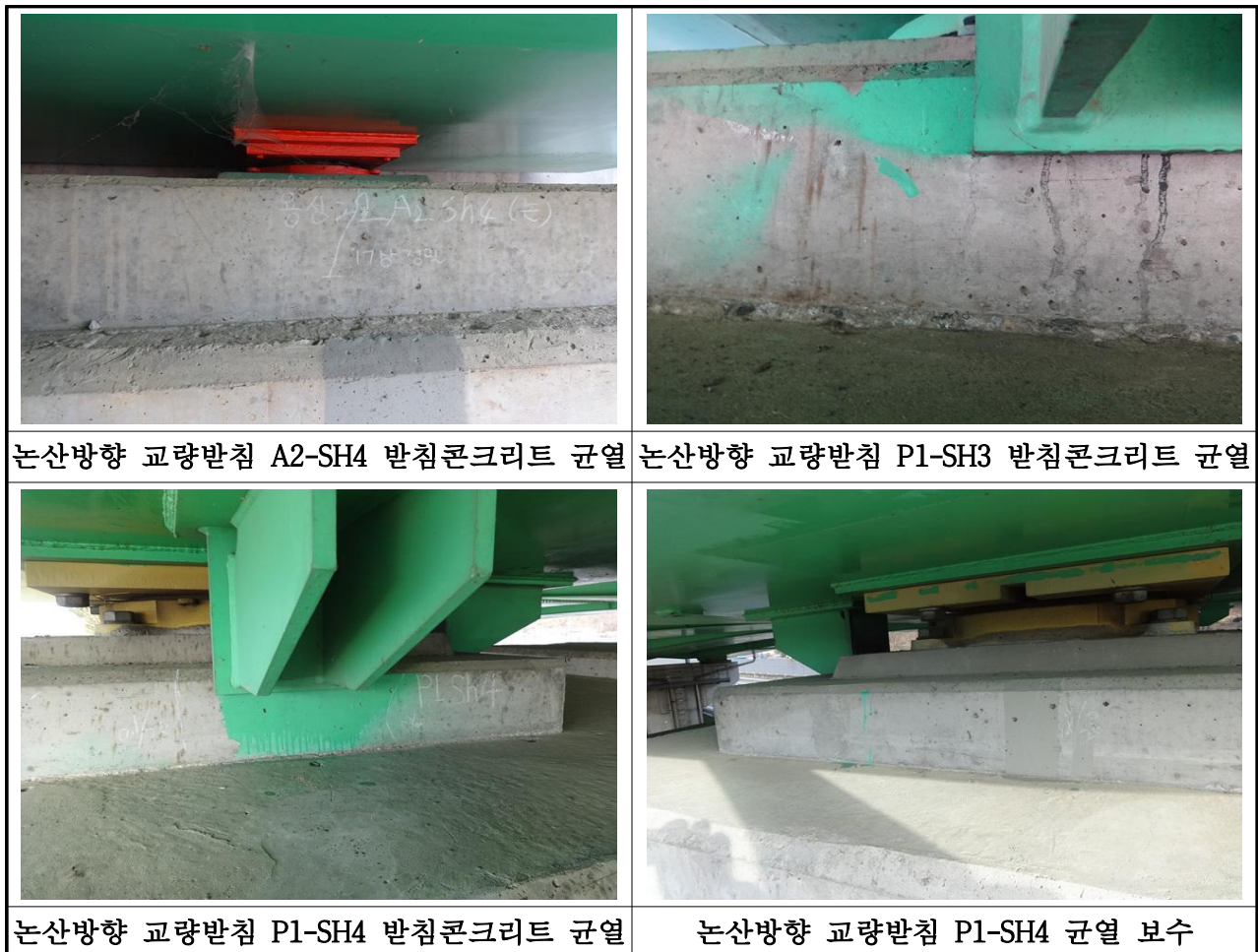
【사진 3.37】 교량받침 손상현황
