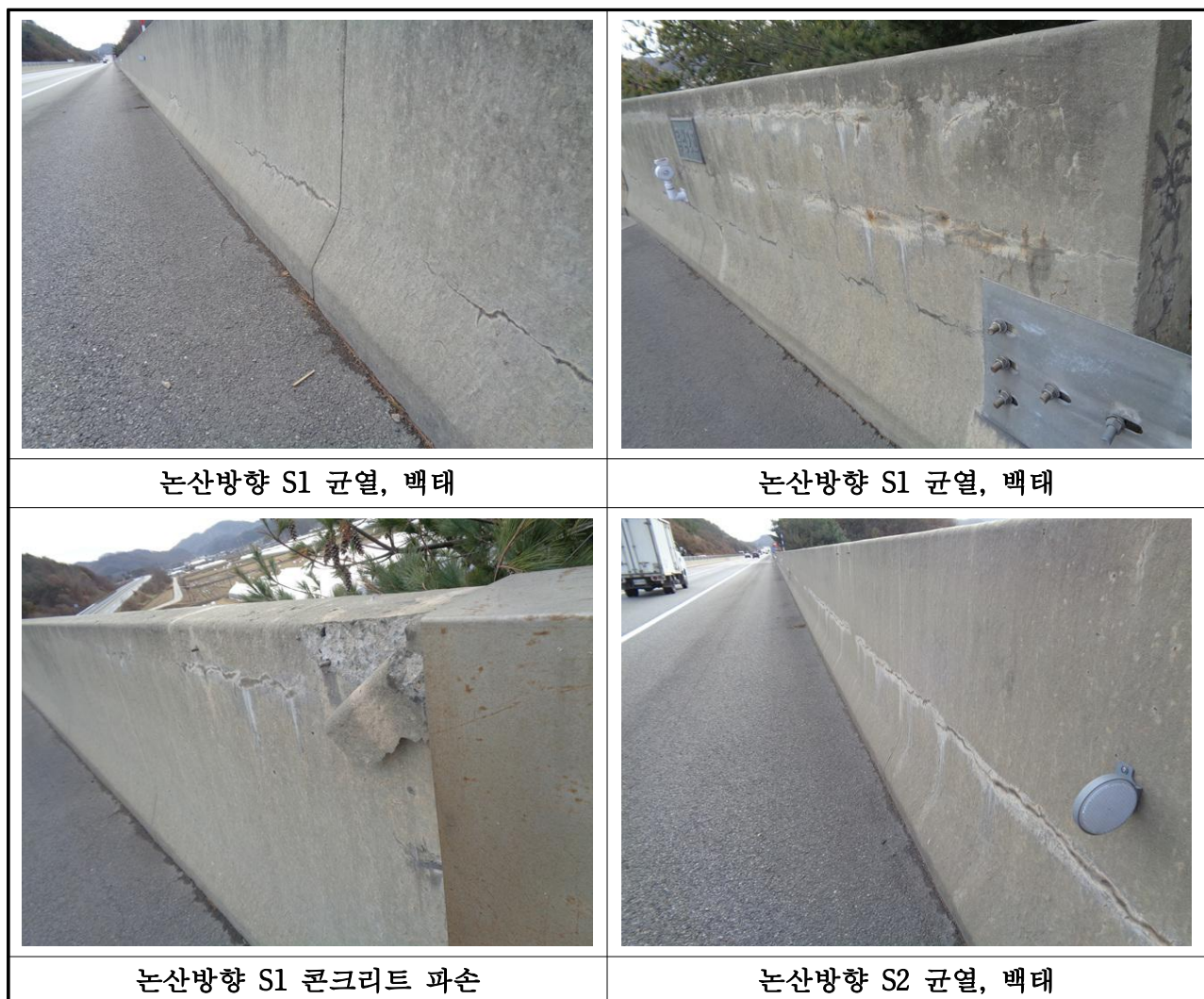
【사진 3.48】 난간 및 연석 손상현황
