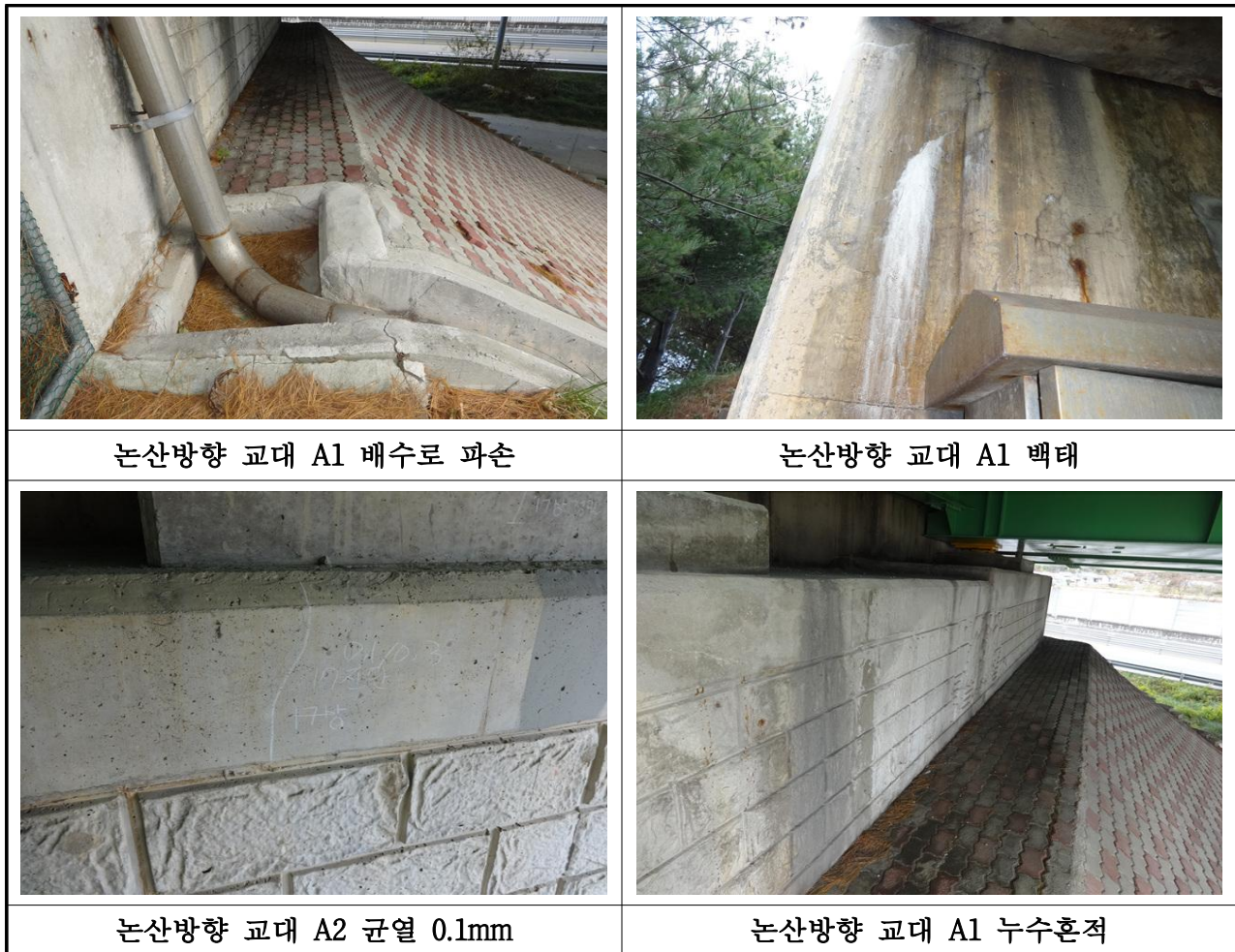
【사진 3.34】 교대 손상현황
