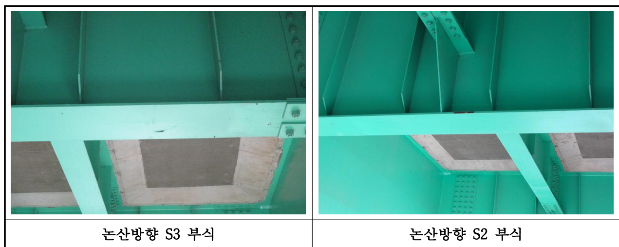
【사진 3.32】 가로보 및 세로보 손상현황
