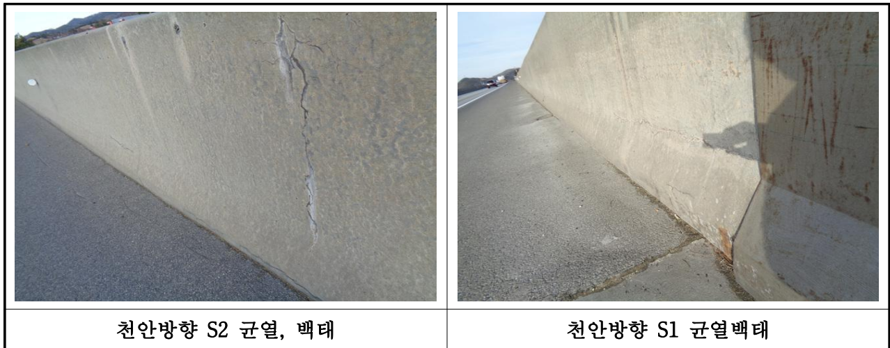
【사진 3.25】 난간 및 연석 손상현황
