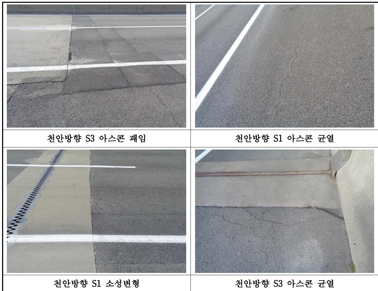
【사진 3.21】 교면포장 손상현황
